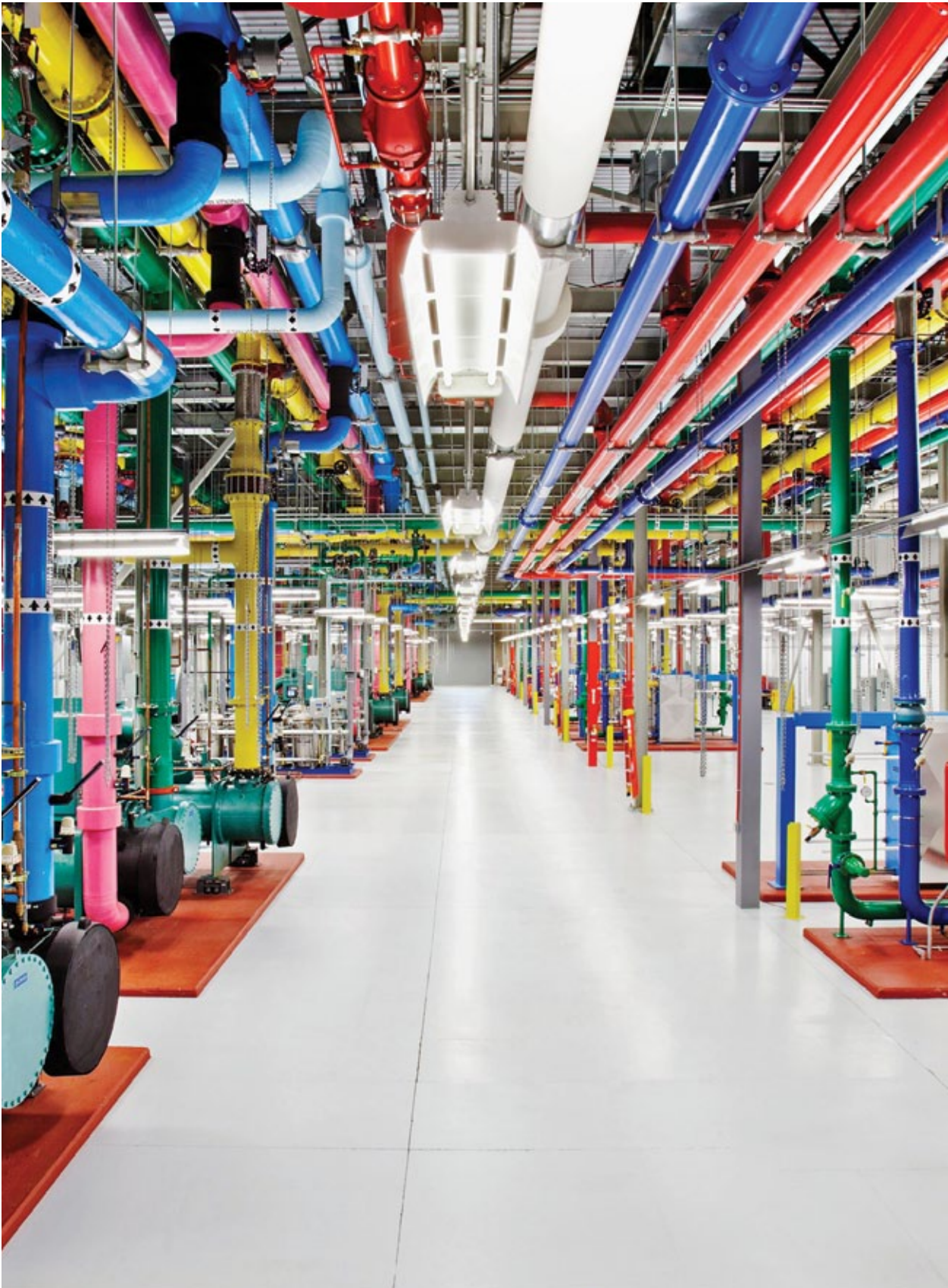
Tubulação de água do sistema de refrigeração do datacenter do Google na Geórgia. Os tubos são pintados não apenas para ficar com a cara do Google, mas também para identificação do fluxo de água. Esta e outras imagens semelhantes dos datacenters do Google podem ser vistas em: http://www.google.com/about/datacenters/gallery
