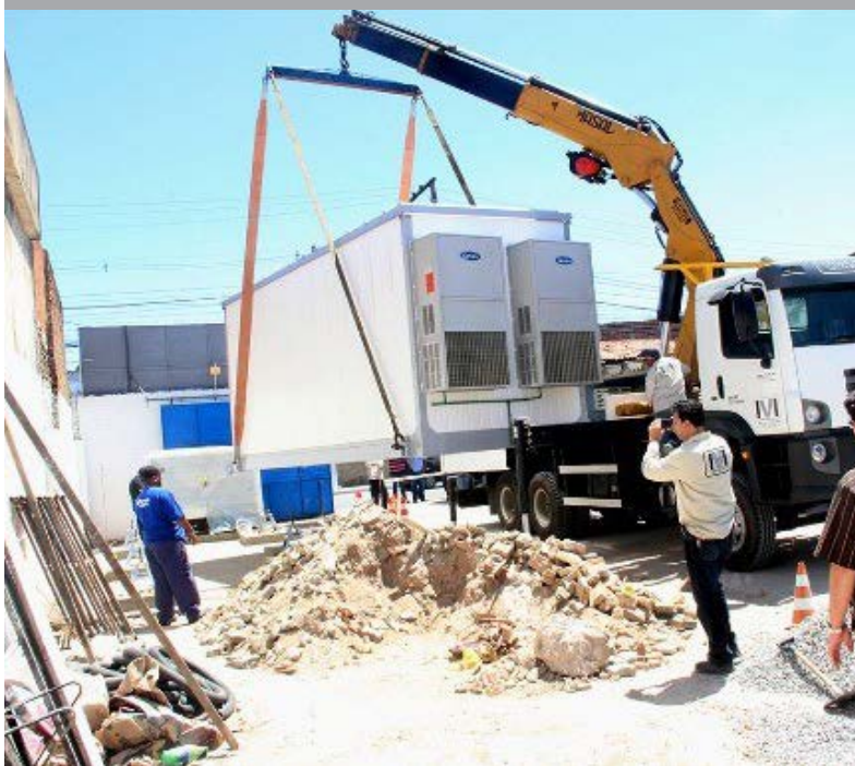
Nova Infovia possui a infraestrutura de um Datacenter completo
